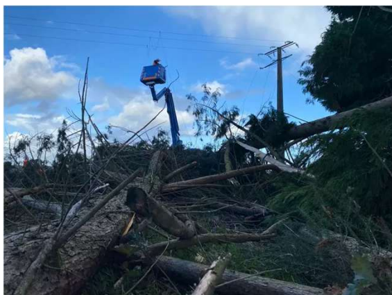
Tempête Ciaran novembre 2023 (source Enedis)
