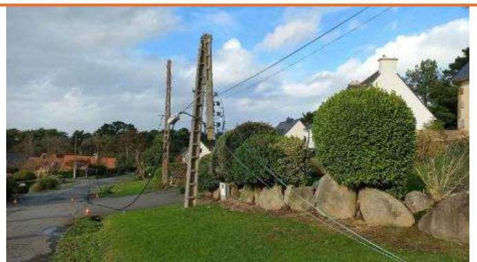
Tempête Ciaran novembre 2023 (source Enedis)
